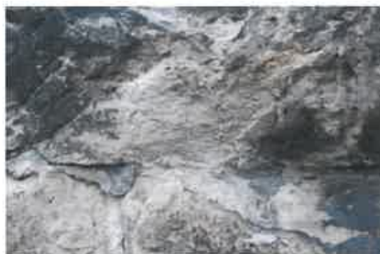
obr. 6 hloubková koroze kamene
