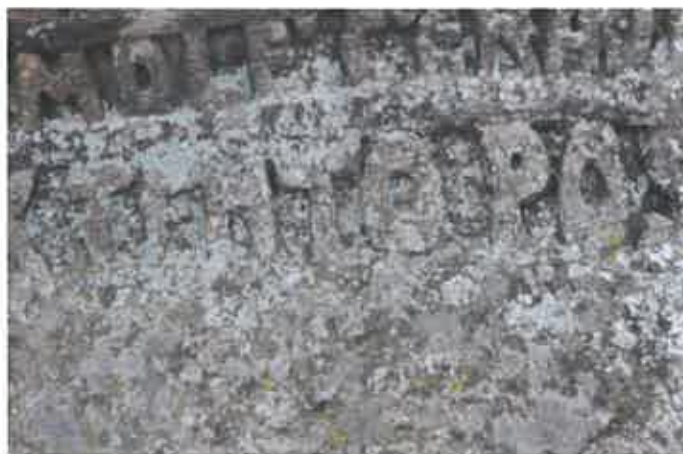
obr. 2 povrch pokrytý biologickými povlaky
