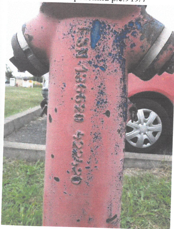
Hydrant na pozemku p.č.708/34
