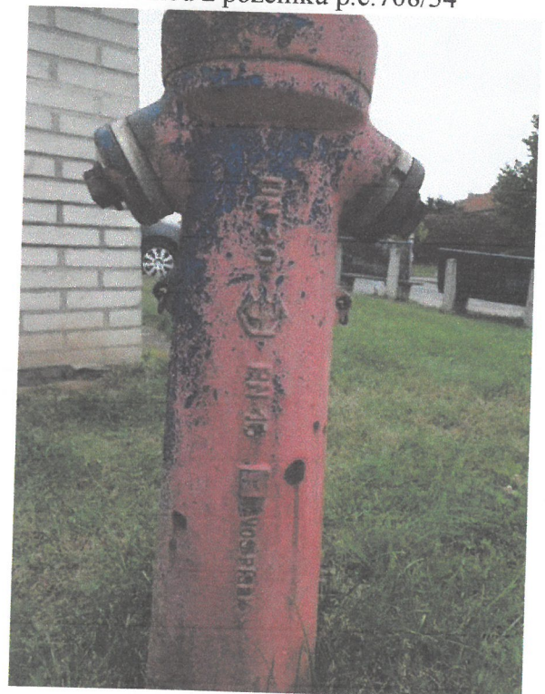
Hydrant na pozemku p.č.708/34
