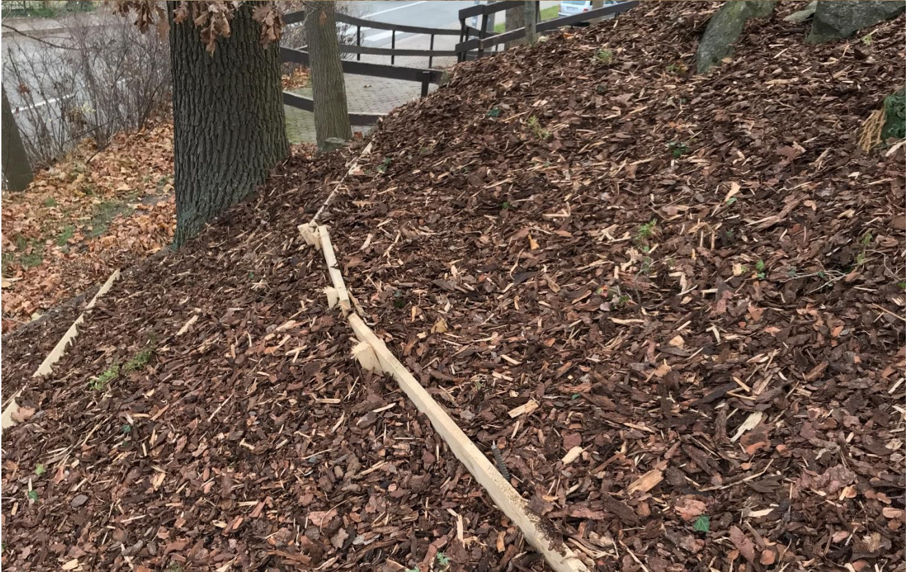
ukázka zpevnění svahu jutovou sítí a následně eliminace sesuvu mulče pomocí instalace dřevěných prken
