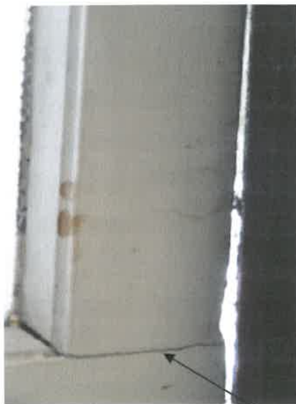
Pavilon A – fasáda kotelna
