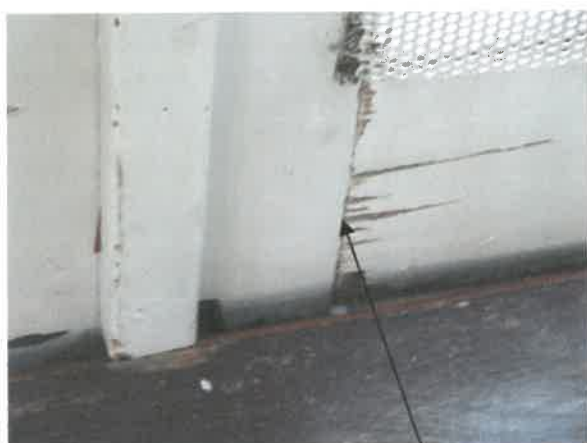
Pavilon A- fasáda kotelna
