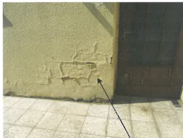
Pavilon A – fasáda kotelna
