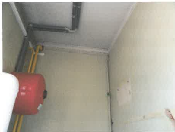
Pavilon A - kotelna
