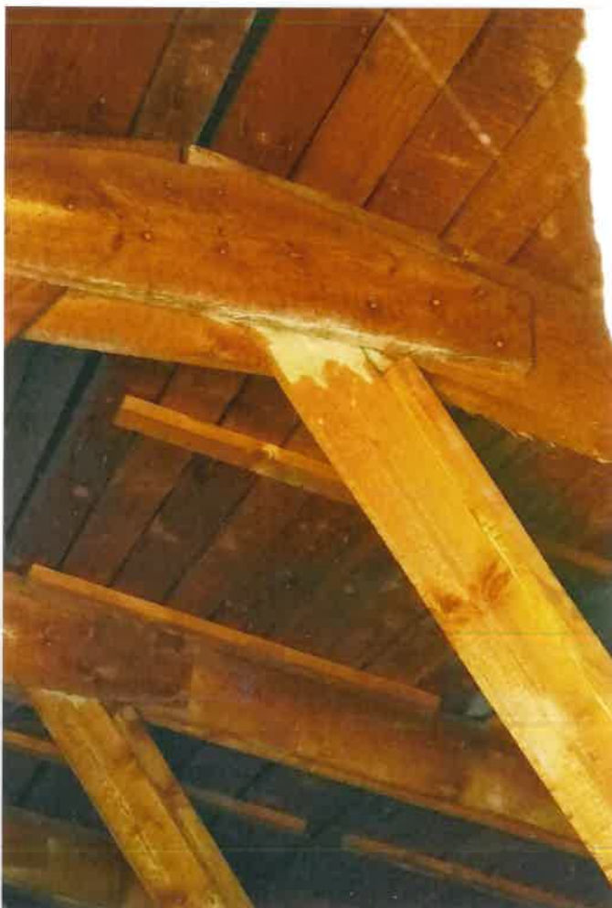
foto č. 2- poškození trámů krovu v objektu B voštinovou hnilobou
