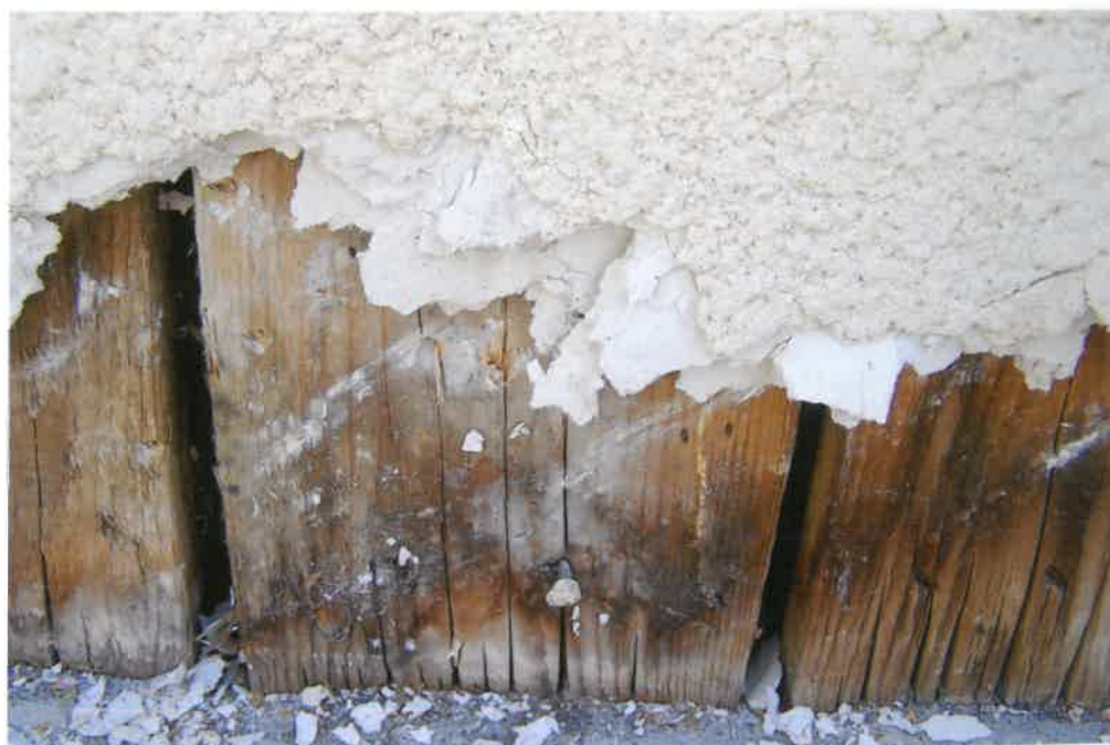
foto č. 12-stav prken pobití stěny – hniloba, objekt B
