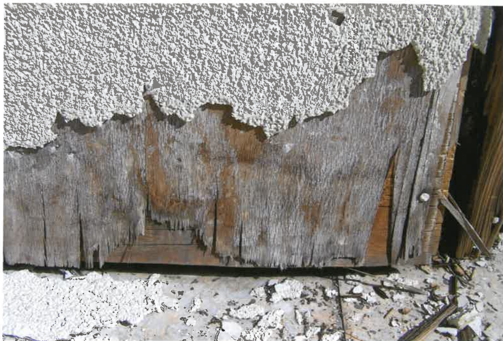
foto č. 11- stav pobití obvodové stěny v objektu B - hniloba
