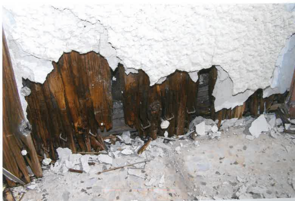
foto č.10 - prkna pobití stěny, rozpad způsobený hnědou hnilobou, objekt D
