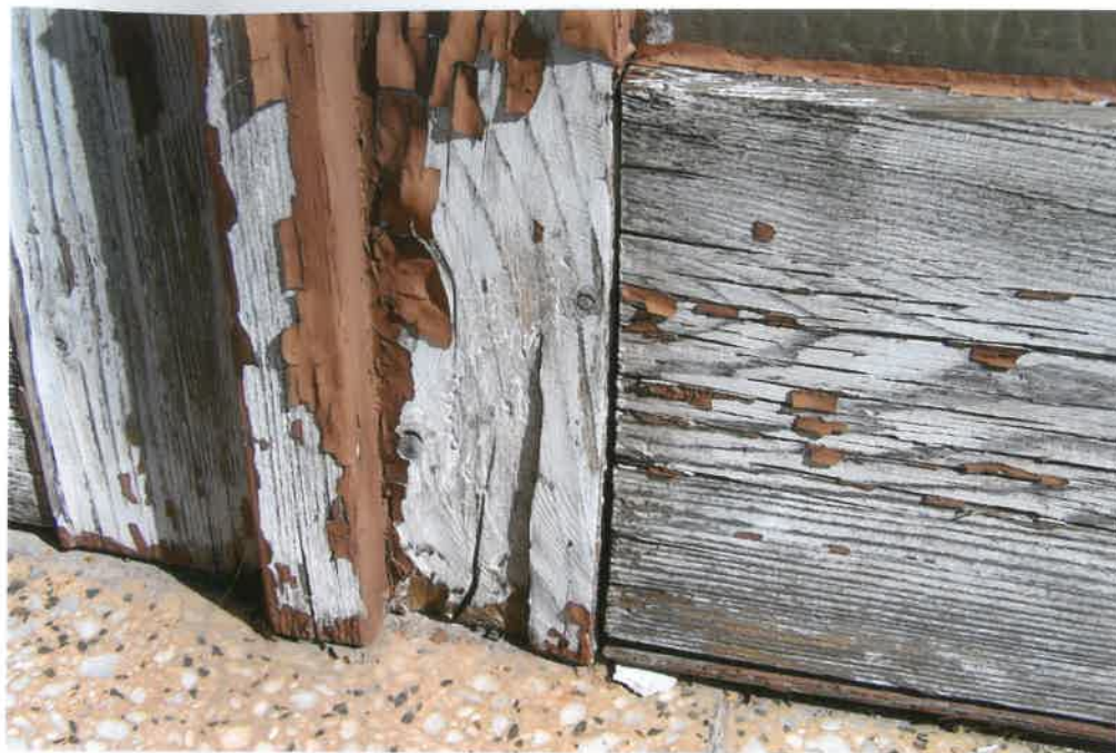
foto č. 7- detail poškození dveří hnilobou v objektu B
